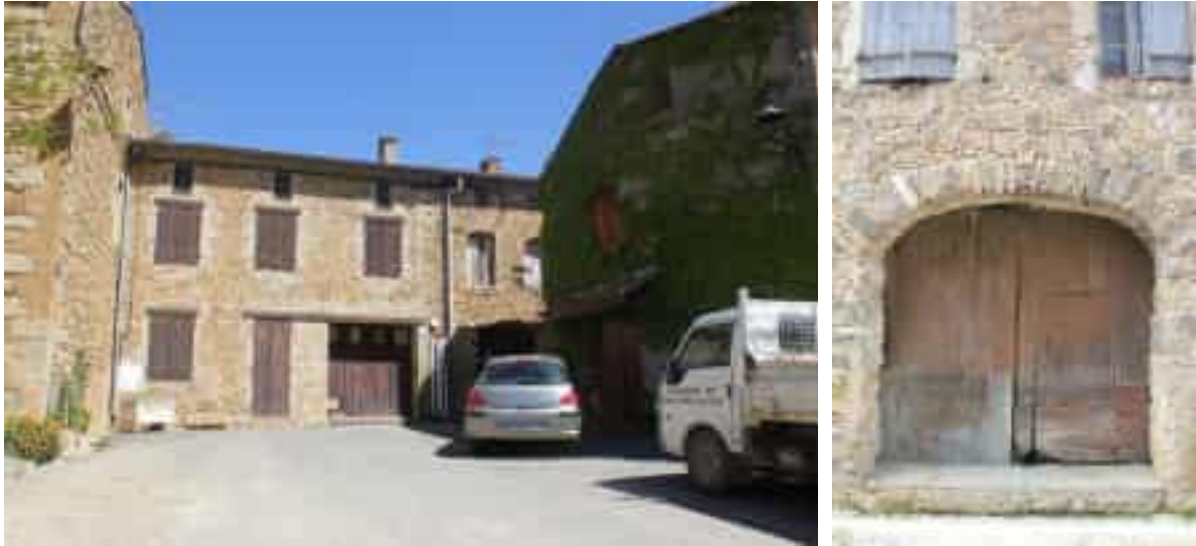
Figure 9 : Des incrustations en cayrou sur une façade en moellons de pierre à Soulatgé et à Fraissé-des-Corbières - Source : AURCA
